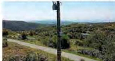
Le panorama depuis Vélieux, gâché par les poteaux aériens.
