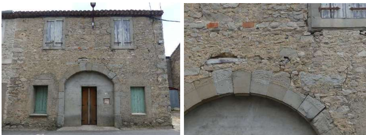
Maison 11 rue des Ecoles, élévation principale et détail du ressaut formant la limite de l'enduit, aujourd'hui « décrouté ».
