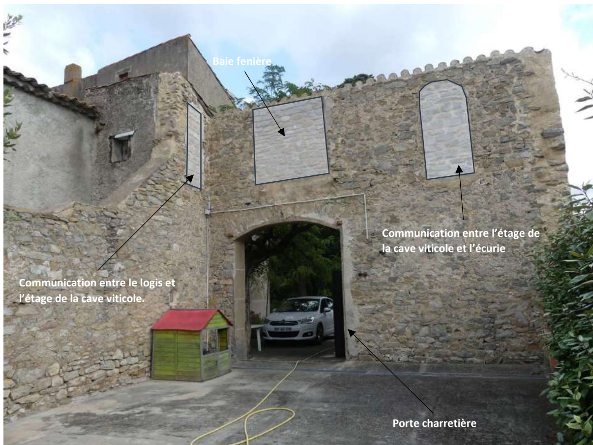
Maison 14 rue des Fossés : Vue intérieure du chai, qui s'est écroulé il y a quelques années, permettant de rendre compte des anciennes communications entre les trois corps de bâtiment.
