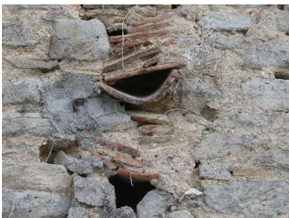
Sortie d'évier, maison 3 place de la Fontaine.
