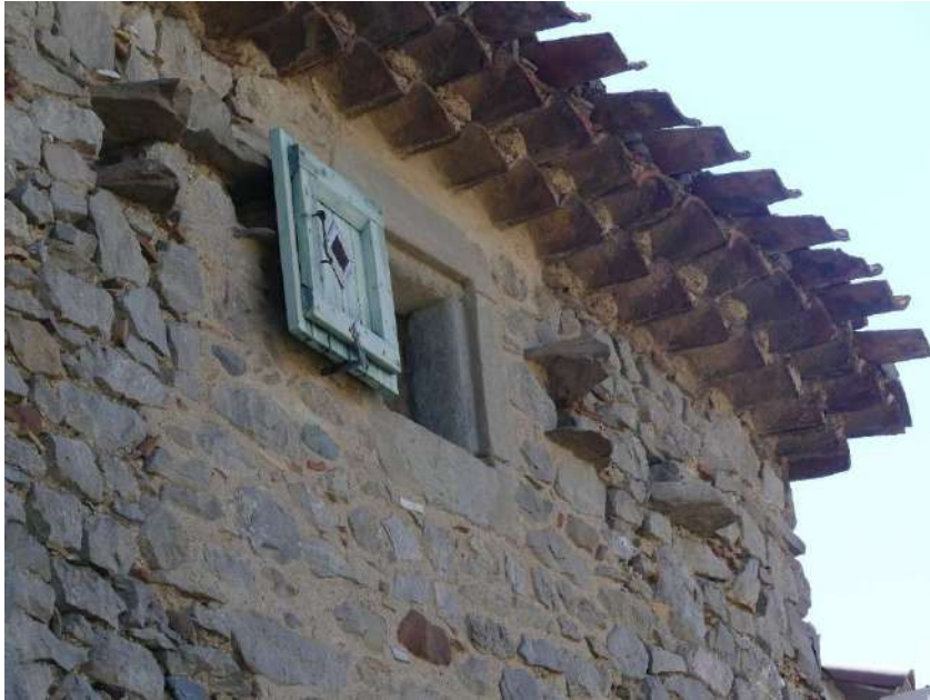
Maison 8 rue Saint-Martin, génoise à deux rangs et tuiles débordantes.
